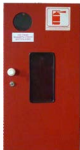
Шкафы для огнетушителя
